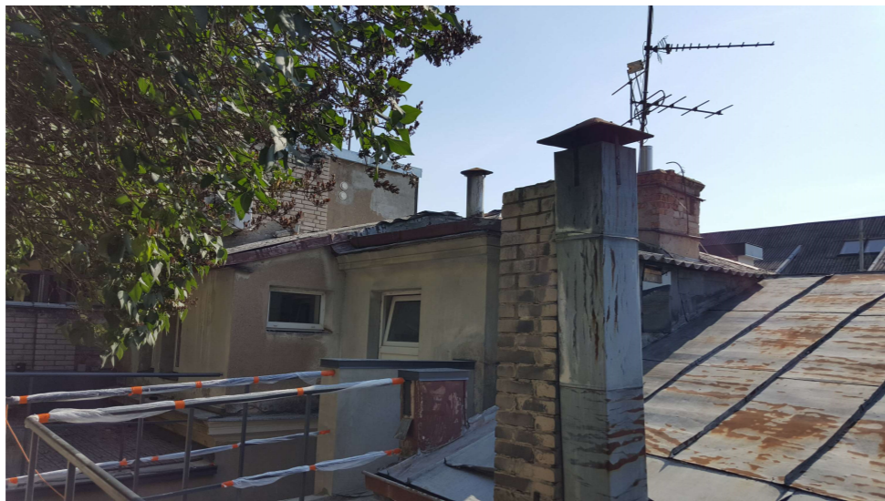
Esama šiaurinės pusės būklė
