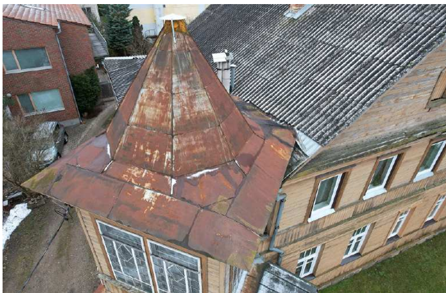
10 pav. Piramidės formos stogo iš šiaurinės pusės dangos būklės vaizdas
