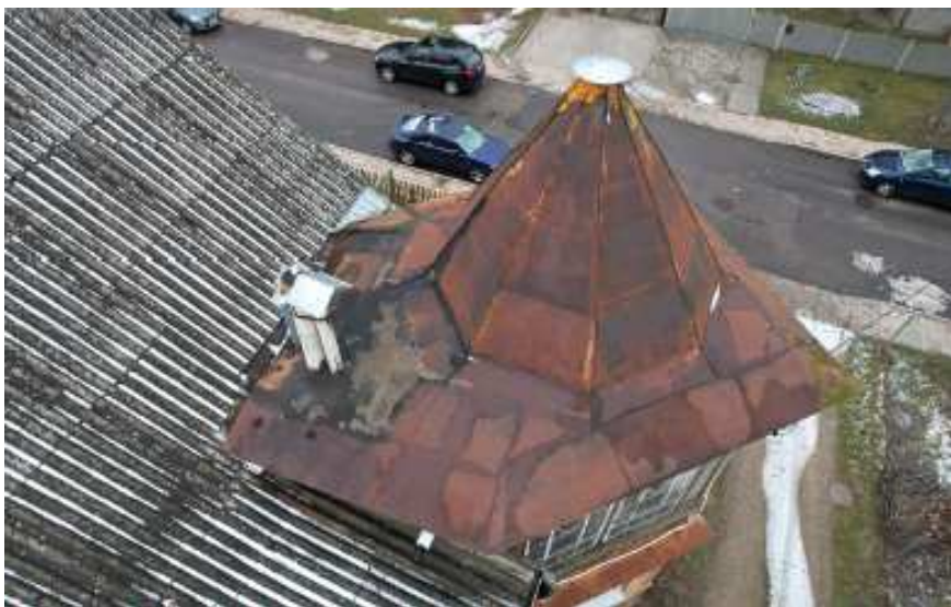
9 pav. Piramidės formos stogo dangos būklės vaizdas
