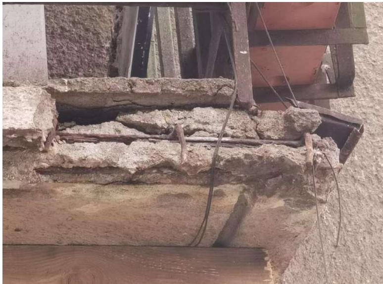
7 pav. Sekančio balkono tvorelės statramsčio tvirtinimo į g/b plokštę būklės vaizdas:
