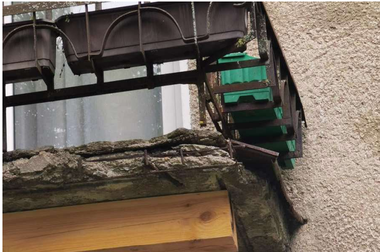
3 pav. Balkono tvorelės statramsčio tvirtinimo į g/b plokštę būklės vaizdas: TUB16x16 visiškai nukorodavęs
