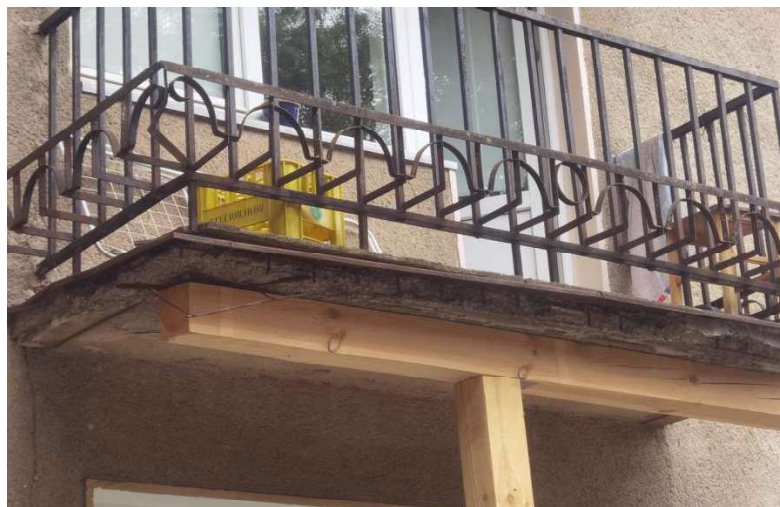
5 pav. II a. buto Nr. 6 išramstytos balkono plokštės vaizdas
