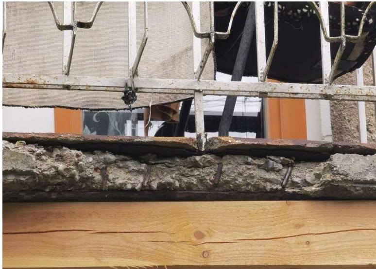
6 pav. Balkono tvorelės statramsčio tvirtinimo į g/b plokštę būklės vaizdas: TUB16x16 visiškai nukorodavęs
