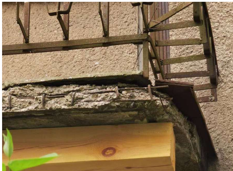
4 pav. Dar vieno balkono reprezentuojantis balkono tvorelės tvirtinimo mazgo suirimo vaizdas
