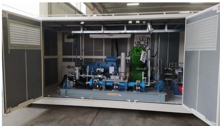
pav. 4 Kompresoriaus konteineris
