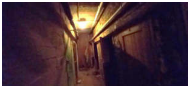
11 pav. Nusidėvėjusios, senos vidaus inžinerinės sistemos, korduoja vamzdynai, vamzdynų izoliacija sena, vietomis vamzdynai neizoliuoti.
