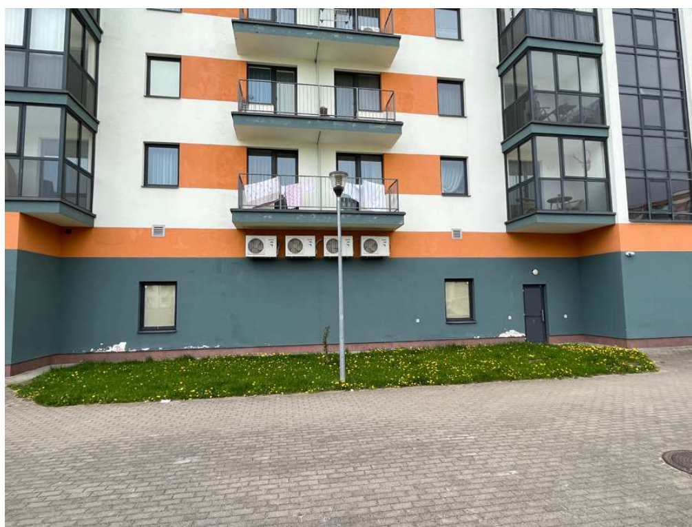
4 pav. III korpusas, rytinis fasadas: I a. tarp laiptinių (butai 48-72 ir 25-48) dalyje atšokęs tinkas
