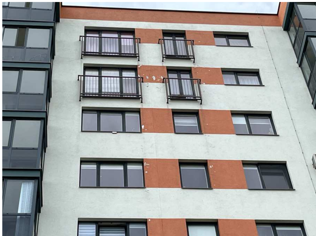
18 pav. II korp., rytinis fasadas: tarp laiptinių (butai 33-56 ir 1-32 ties V ir VI aukštais tinko pažaidos
