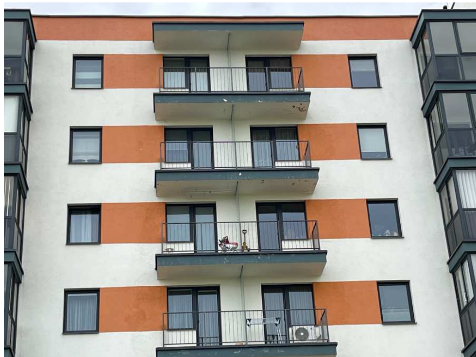
2 pav. III korpusas, rytinis fasadas: balkonų plokštėse atšokę fasadiniai dažai
