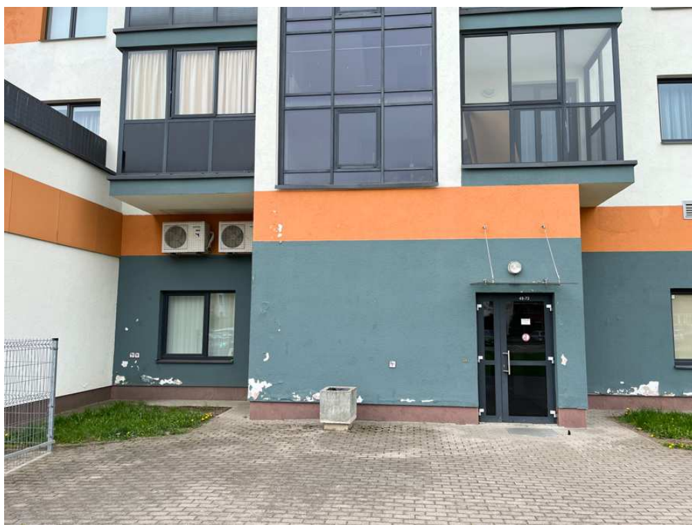
3 pav. III korpusas, rytinis fasadas: I a. laiptinės (butai 48-72) dalyje atšokęs tinkas
