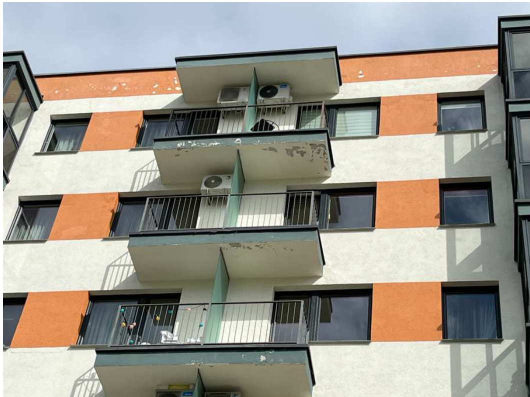
13 pav. III korpusas, vakarinis fasadas: ties laiptine (butai 48-72) balkonų ir fasado būklės vaizdas
