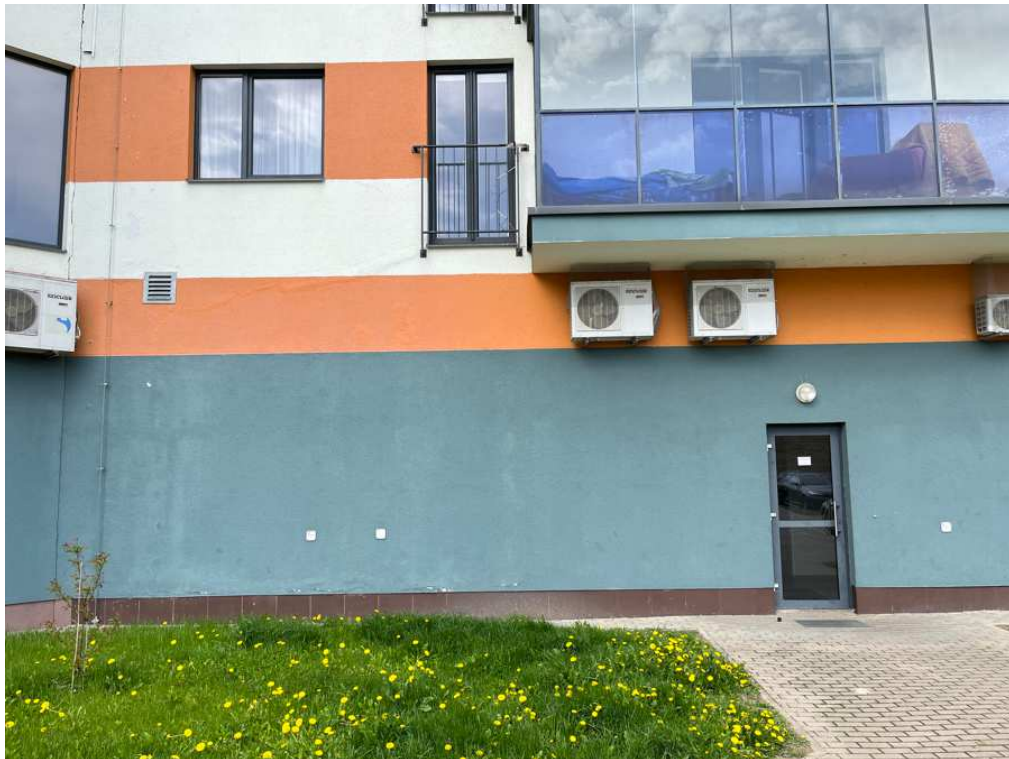
22 pav. I korp. pietinis fasadas: laiptinės (butai 48-72) I a. tinko pažaidos ties cokoliniu profiliu
