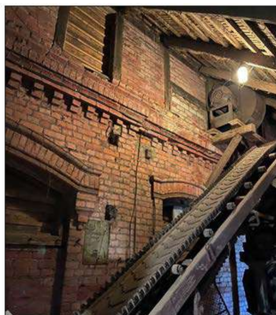
Patenkinamos būklės fasadas paveiktas priestato konstrukcijų ir techninės įrangos
