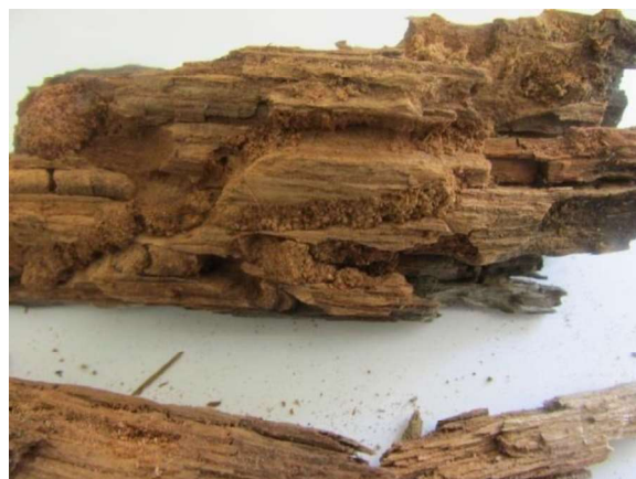
2 pav. Atvežtos medinės konstrukcijos Nr. 1 pažeistos entomologinių kenkėjų
