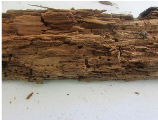
5 pav. Atvežtos medinės konstrukcijos Nr. 2 pažeistos entomologinių kenkėjų
