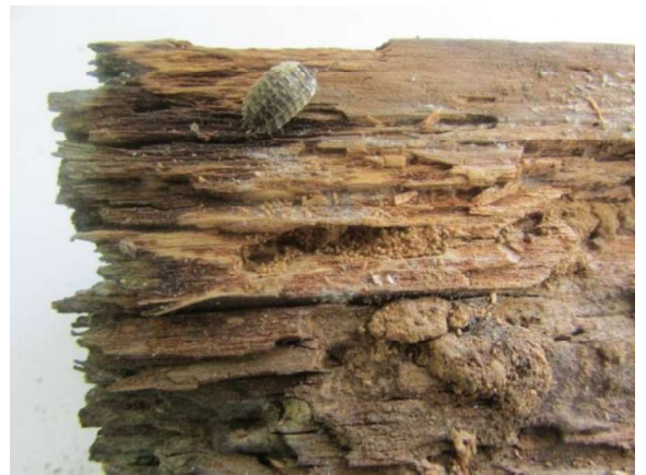
7 pav. Atvežtos medinės konstrukcijos Nr. 3 pažeistos entomologinių kenkėjų
