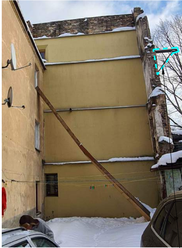
Išlikusios buvusio balkono konstrukcijos
