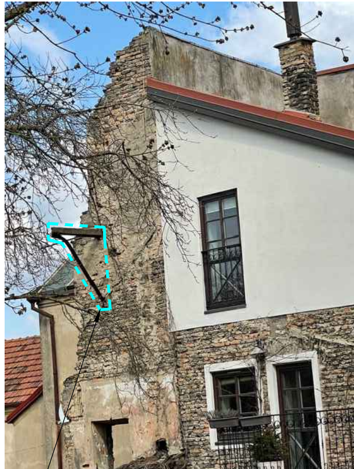
Išlikusios buvusio balkono konstrukcijos
