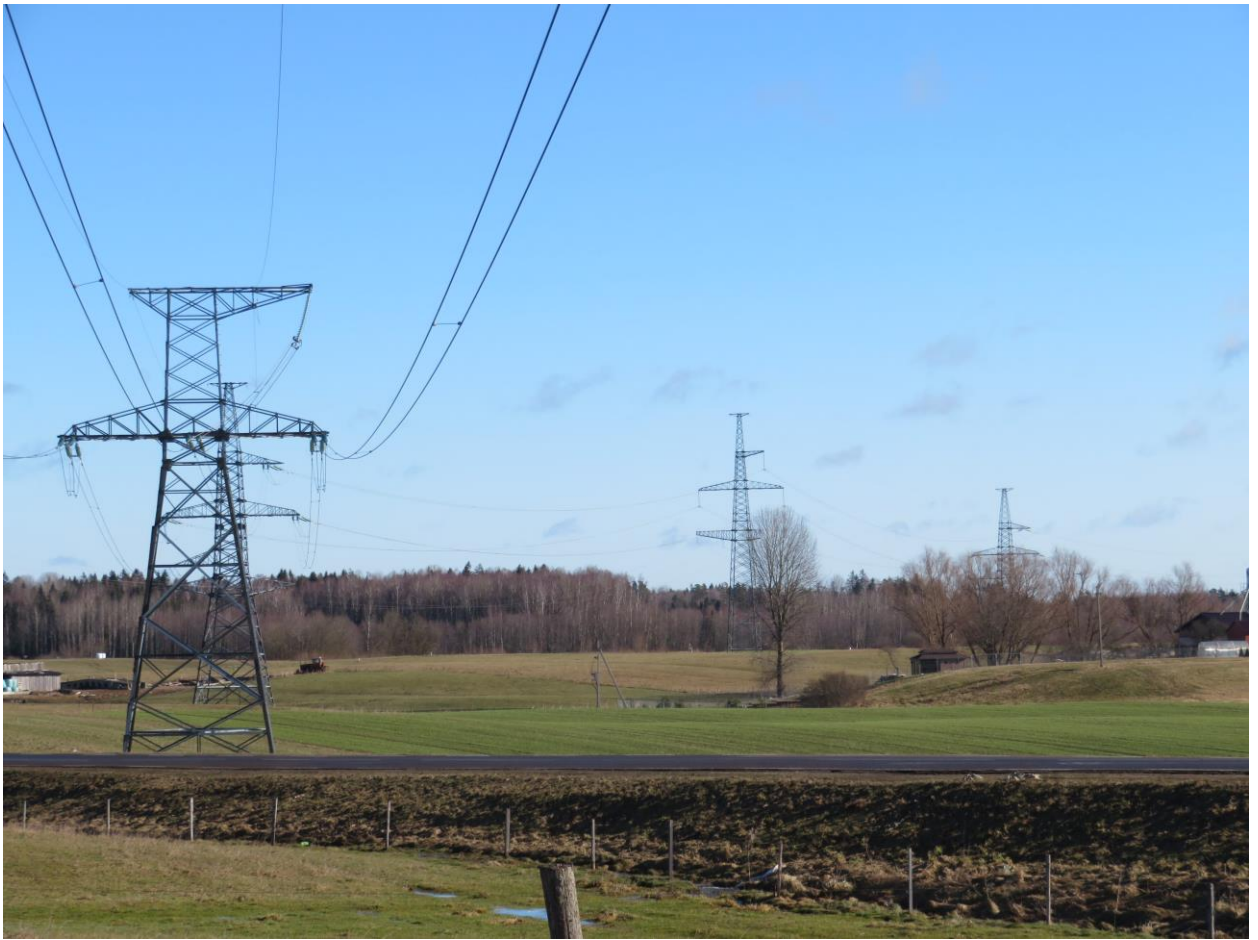
18 pav. 330 kV orinė elektros perdavimo linija
