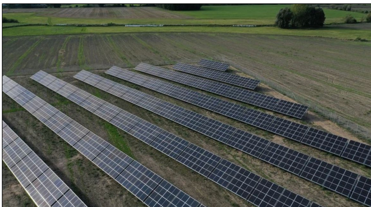
1 pav. Fiksuoto kampo konstrukcijų saulės elektrinių parko bendras vaizdas
