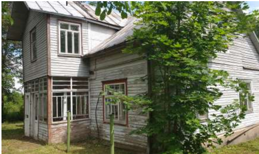
14. pav. Pastato lauko sienos fragmentas, langai be palangių, vietomis lauko sienos liečiasi su gruntu, nuogrindos nėra
