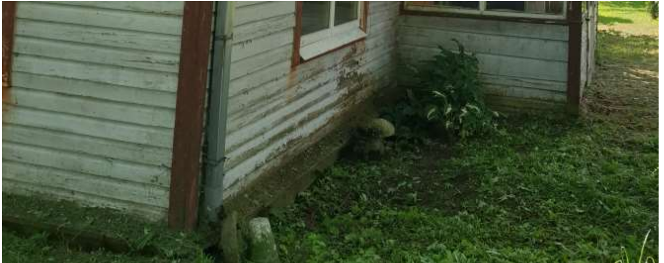
10 pav. Pastato cokolio fragmentas su išoriniu lietaus surinkimo vandens šalintuvu, neapsaugotas nuo kapiliarinės drėgmės Sienų išorinė apdaila, ne visur yra palangės po langais
