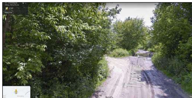
2. Tyzenhauzų gatvės būklē ties sankryža su Jotvingių gatve
