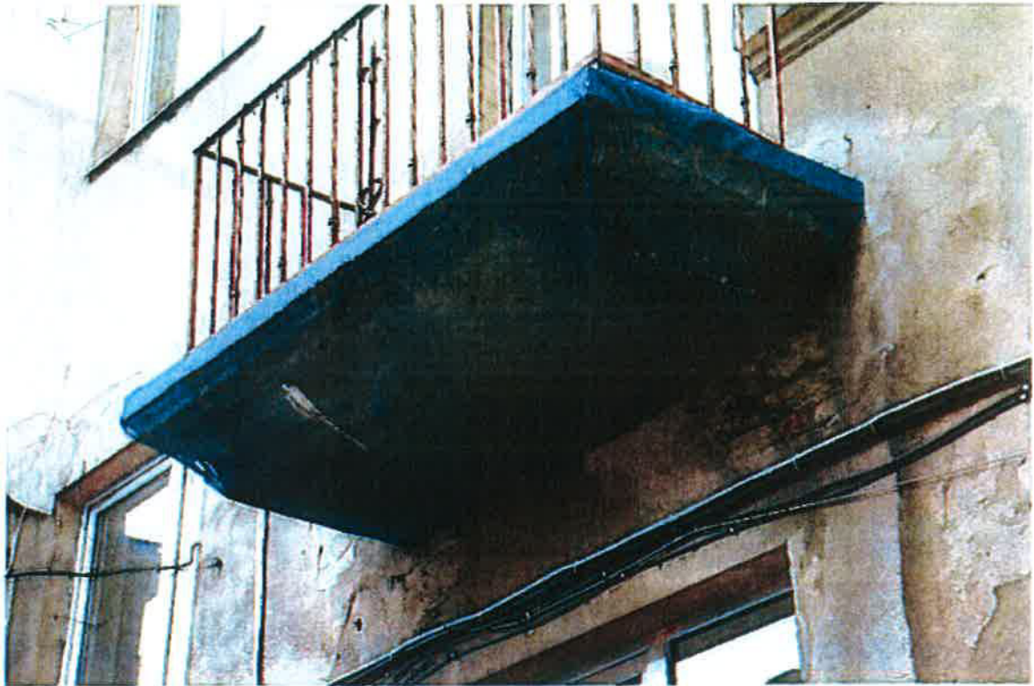
14 pav. Mūrinių sienų pažaidos balkonų sijų atramose
