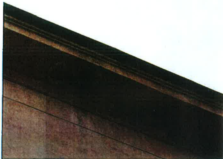
12 pav. Pažeistos parapeto plokštės
