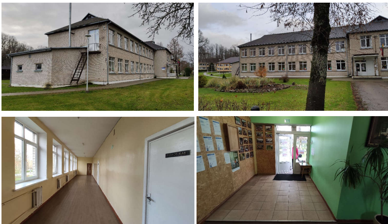
1 pav. Esamas pastatas. Pastato išorės ir vidaus būklė.
