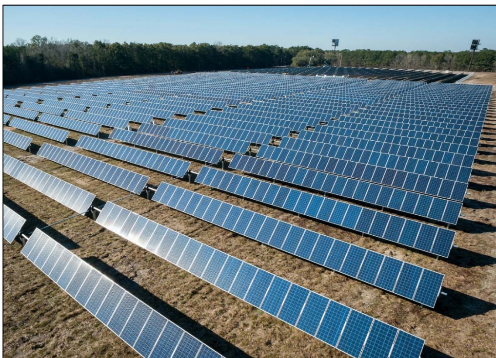
2 pav. Saulę sekančių konstrukcijų saulės elektrinių parko bendras vaizdas
