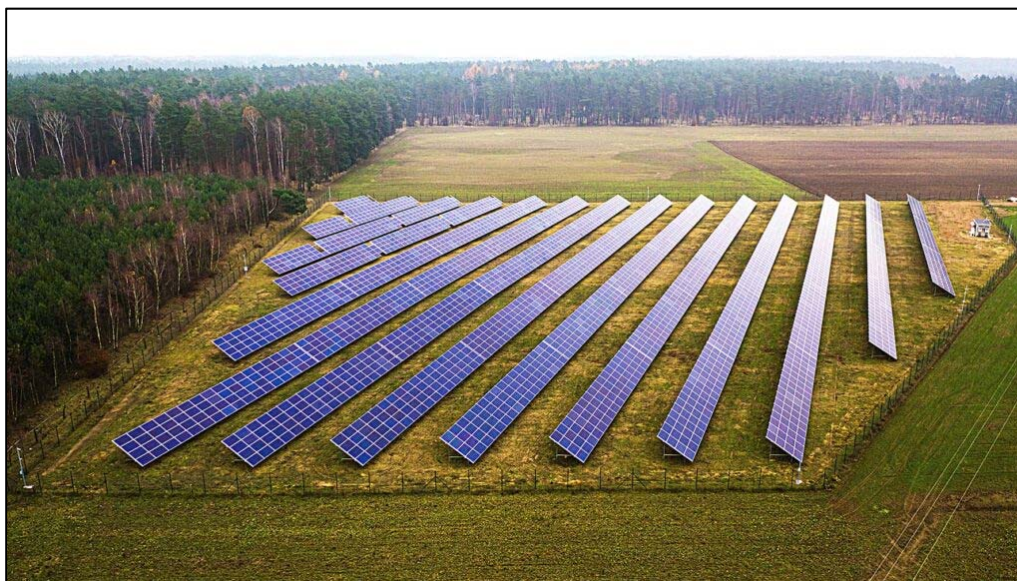
1 pav. Fiksuoto kampo konstrukcijų saulės elektrinių parko bendras vaizdas
