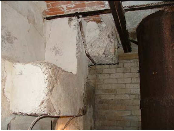
01-15. Ventilācijas kanalai rūsyje
