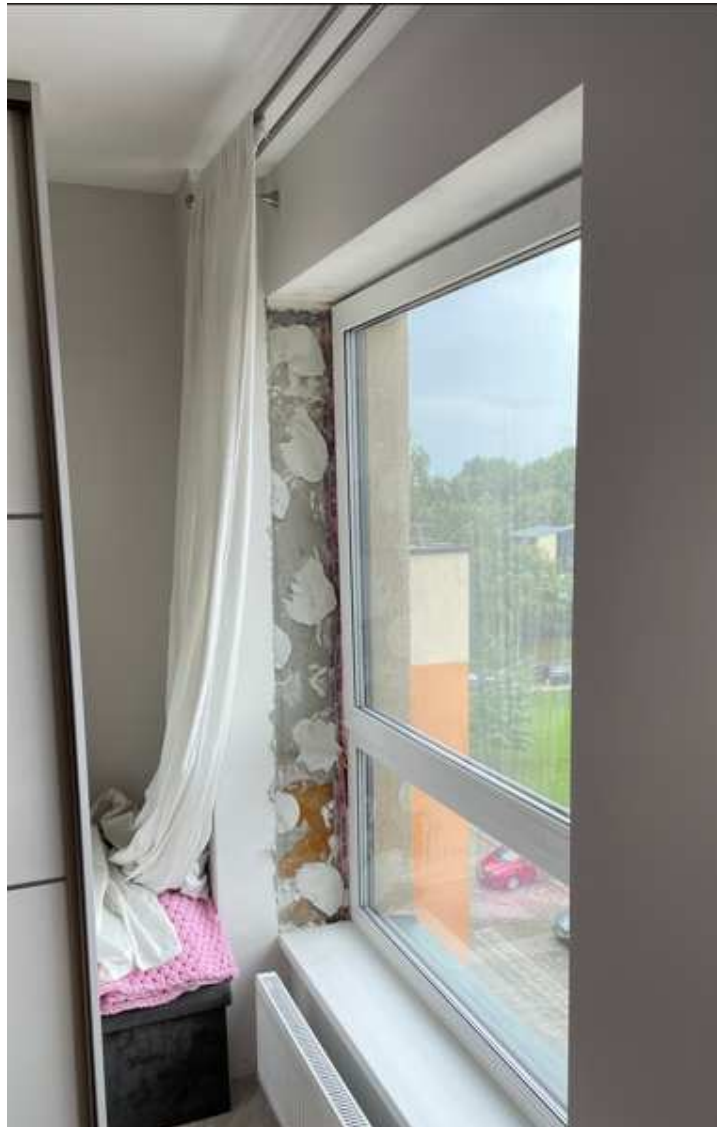
13 pav. Buto Nr. 54 patalpa Nr. 54-3 (žiūrėti sekantį pav., rodykle pažymėta kryptimi): lango perimetru suklijuota Inside garo difuzinė juosta, vandens pažeistos apdailos vaizdas
