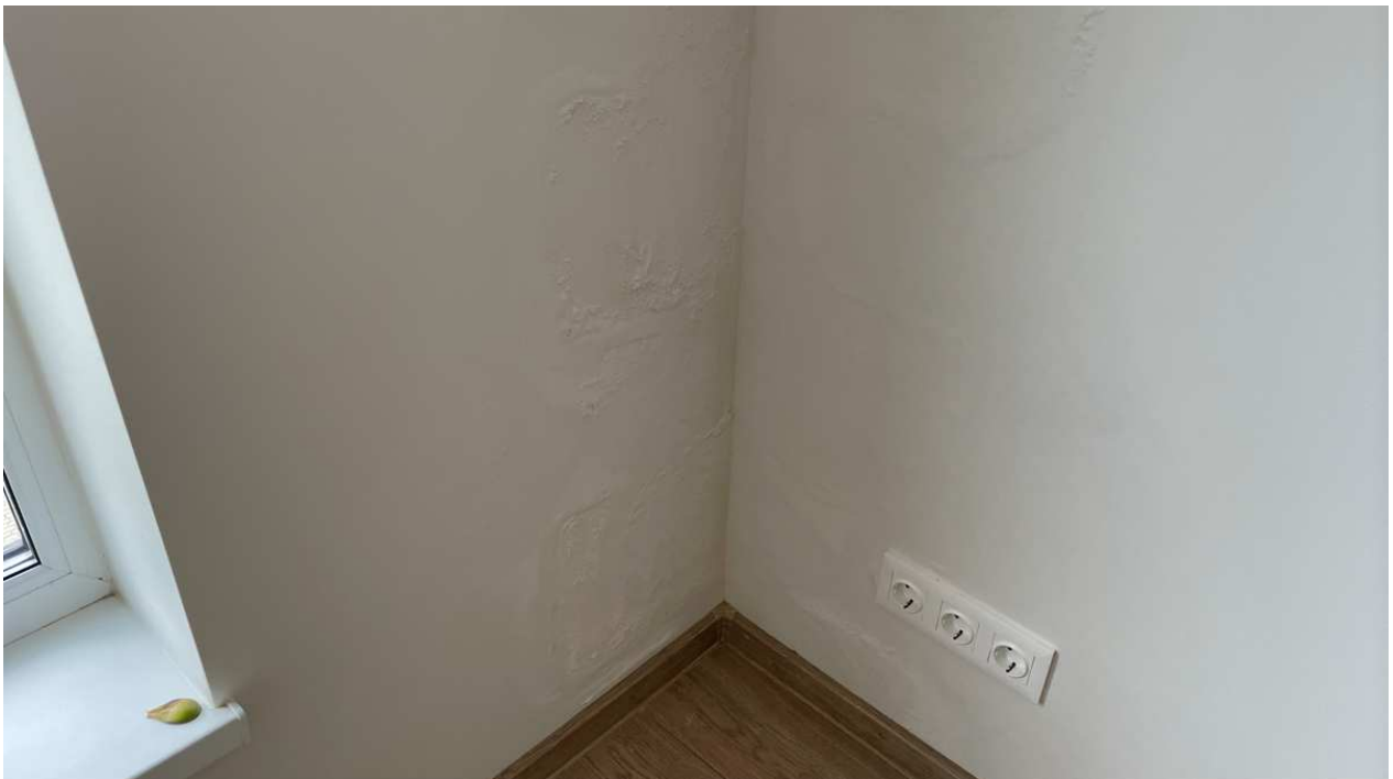
4 pav. VI a. buto Nr. 55 dalyje išorės sienos plote vandens pažeistos apdailos vaizdas.
