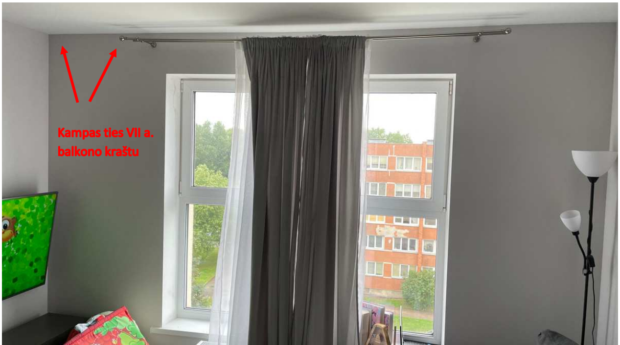
11 pav. Butas Nr. 54 (patalpa Nr. 54-4) išorės siena, kuri po lietaus suliejama vandeniu
