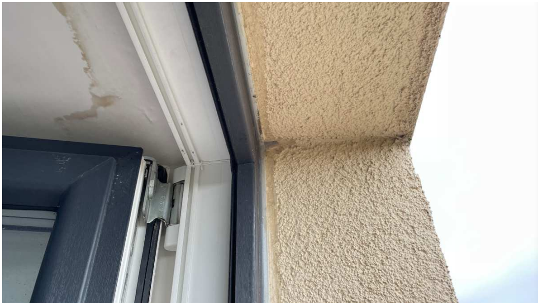
12 pav. Buto Nr. 54 (patalpa Nr. 54-4): fasadinio tinko armavimo sluoksnyje įrengta vandens nulašėjimui briauna, tačiau vandens sulieta apdaila
