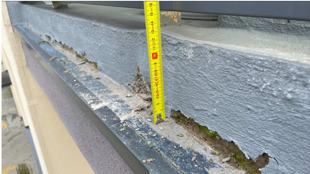
7 pav. Balkono plokštės konstrukcijoje tipinis smulkiagrūdžio betono storis 110 ... 130 mm
