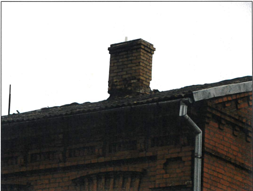
KAMINO VIRŠAUS UŽBAIGIMAS IŠMŪRYTAS TEISINGAI. KAMINO APATINIO MŪRO PLYTOS IŠTRUPĒJUSIOS, KELETAS IŠKRITĒ
