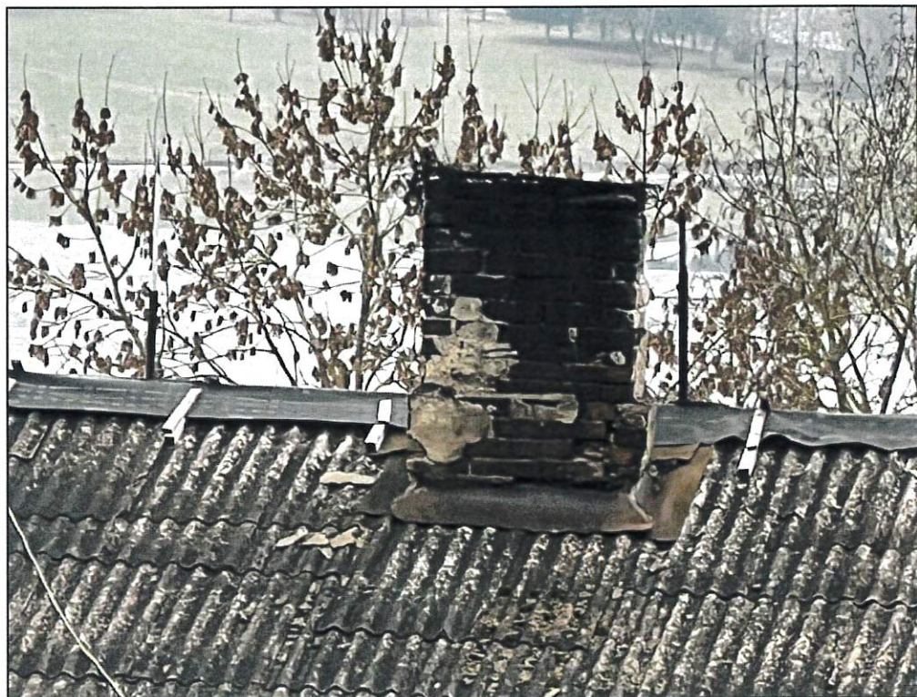
KAMINO BŪKLĖ - BLOGA. PLYTOS VIETOMIS IŠKRITUSIOS, SIŪLĖS – IŠTRUPĖJUSIOS, KAMINAS LABAI APRŪKĖS. APSKARDINIMAS TARP KAMINO IR STOGO DANGOS BLOGOS BŪKLĖS. VIETŲ KRAIGINĖS JUOSTOS MATOSI POLIETILENO PLĖVĖ, KURIA UŽLOPYTA KITA STOGO PUSĖ.
