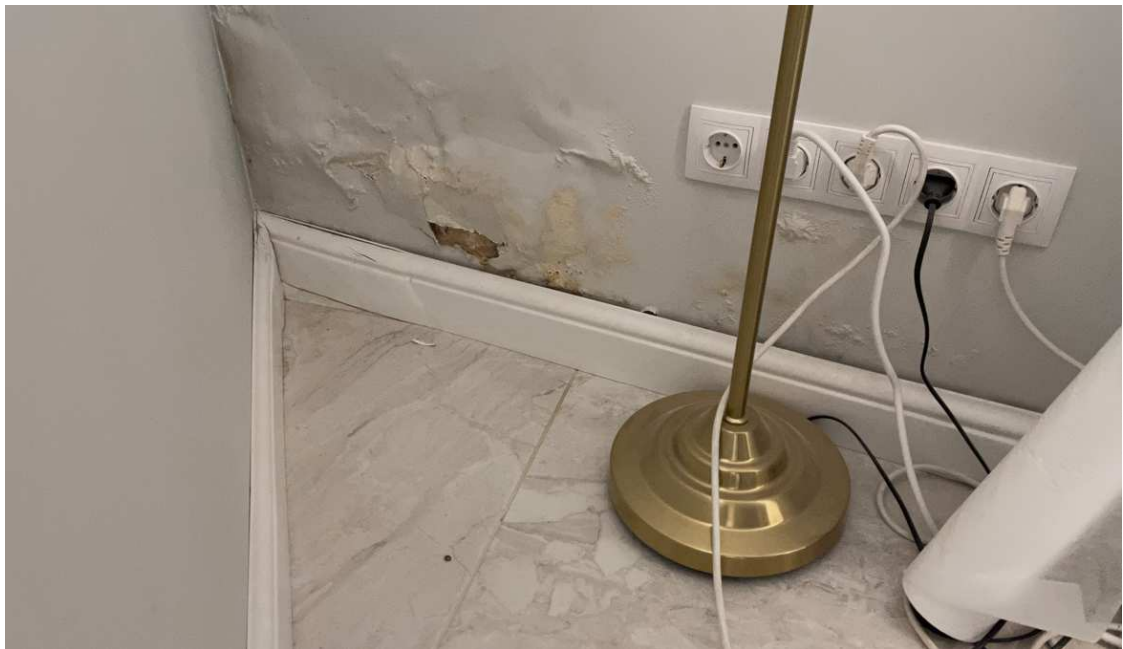
4 pav. „Vieta 1“ – ties I a. grindų perdanga dėl vandens poveikio suirusios vidaus apdailos vaizdas
