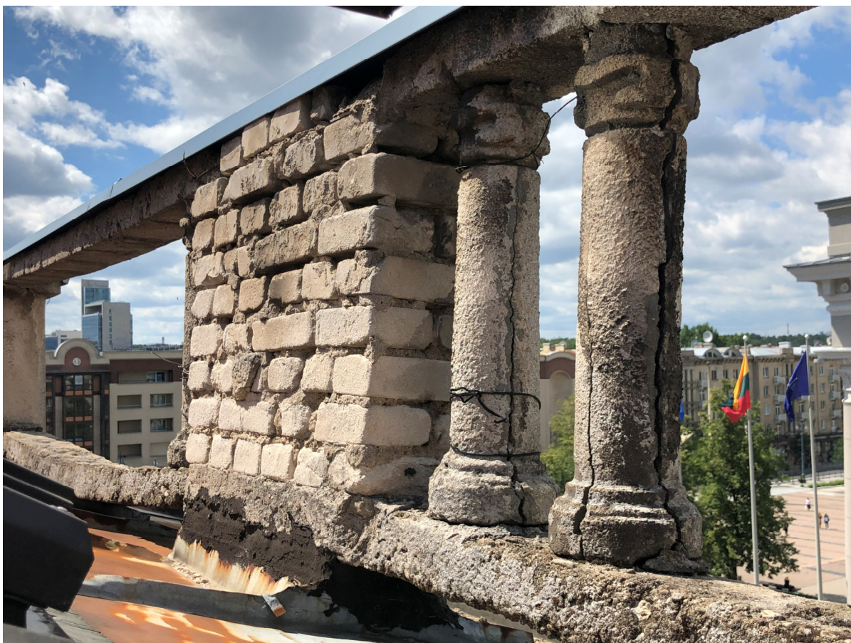
Pažeistas drėgmės tinkas, betonas.
