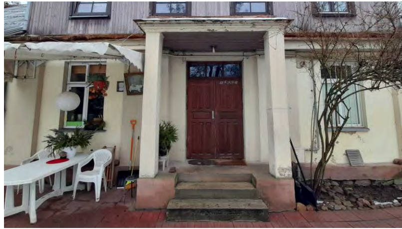
5 pav. Įėjimo laiptų ir aikštelės betonas atskirose vietose nusidėvėjęs, ištrupėjęs. Nėra turėklo.
