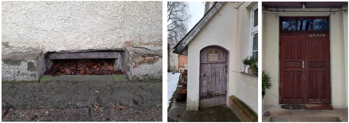
4 pav. Rūsio langai seni, mediniai, nesandarūs. Įėjimo į laiptinę ir šiluminio mazgo durys senos, medinės, nusidėvėjusios.
