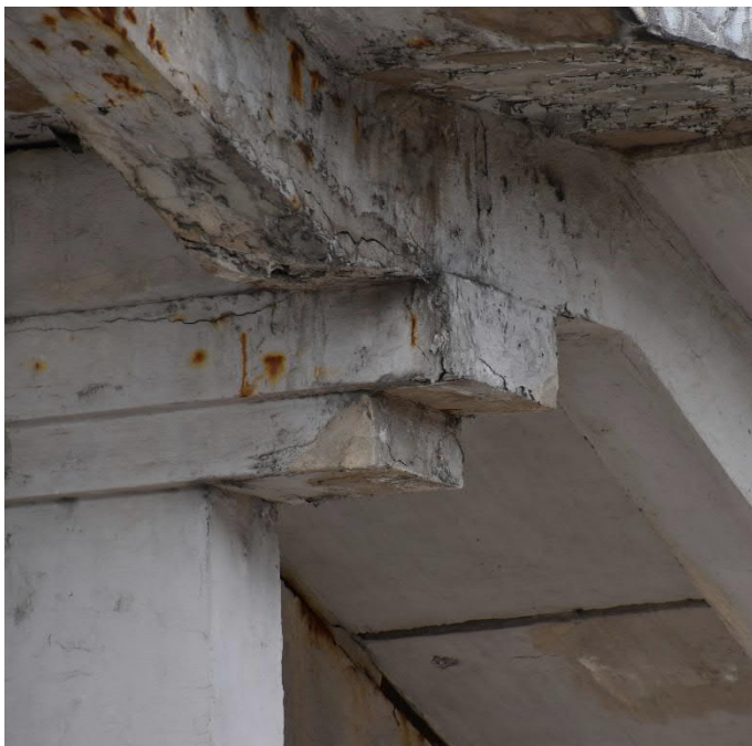
18 pav. Dėl aplinkos poveikio suskilinęs laiptasija.. Išplitusi armatūros korozija.
