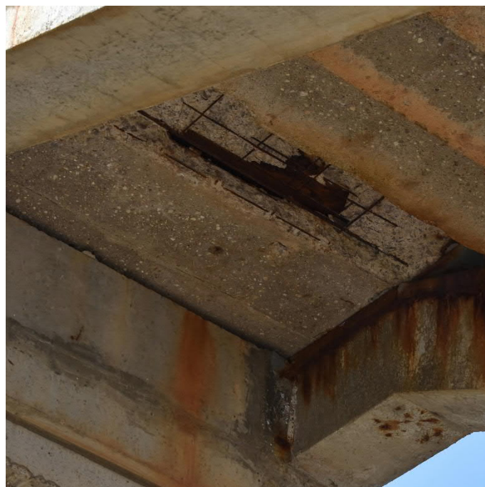
25 pav. Ištrupėjęs betonas.
