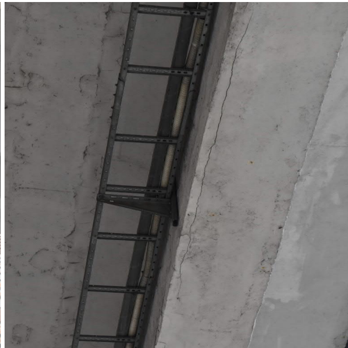
7 pav. G/b tėjinės sijos išilginiai plyšiai sienelės apačioje prie pagrindinės armatūros.
