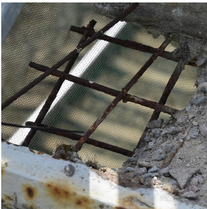
24 pav. Ištrupėjęs betonas.
