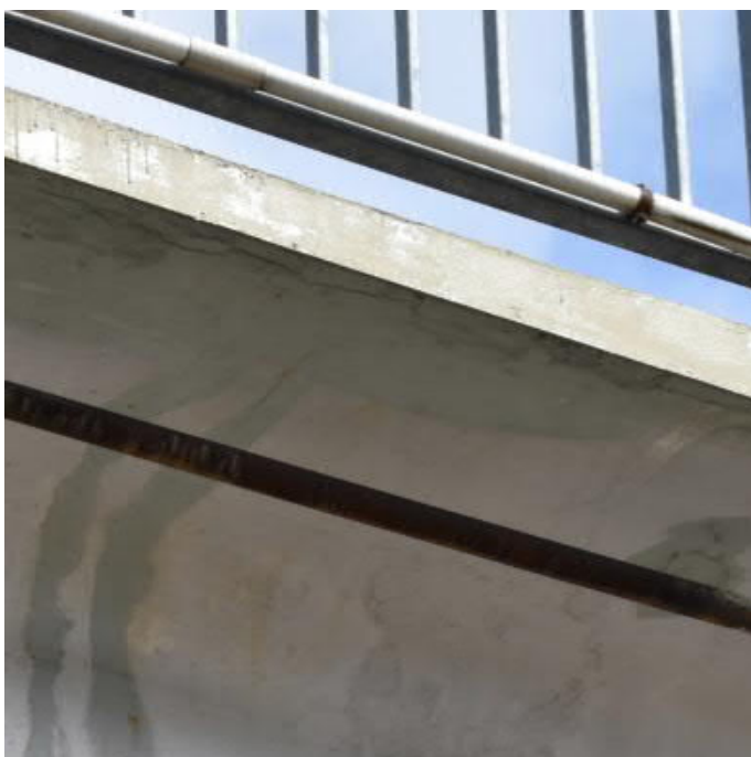
8 pav. Plyšiai gelžbetoninės sijos lentynoje.
