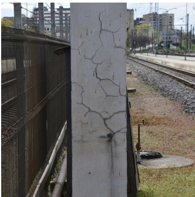
12 pav. Sueižėjęs kolonos apdailinis sluoksnis.
