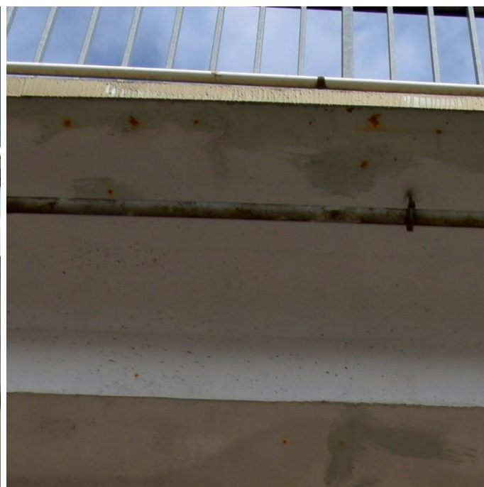
9 pav. Korozijos požymiai gelžbetoninės sijos lentynoje.
