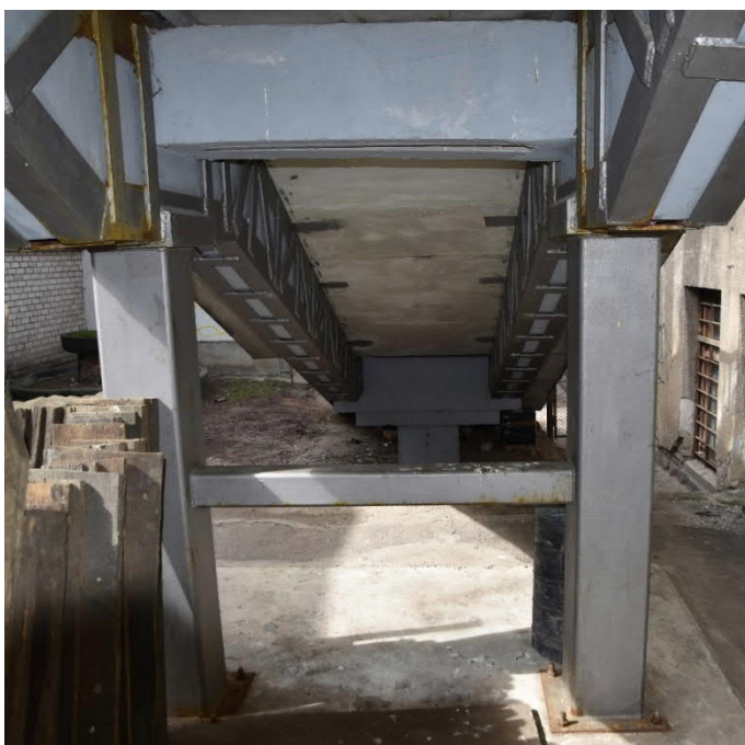
20 pav. Korozijos požymiai laiptasijų stiprinimo elementuose
