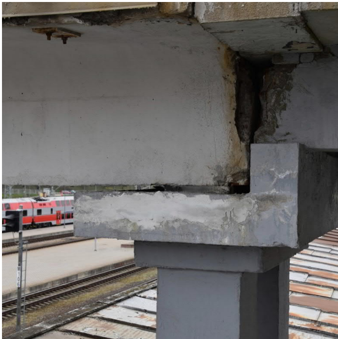
6 pav. G/b tėjinės sijos atraminės dalies defektas. Atšokęs apsauginis betono sluoksnis ir koroduojanti armatūra.
