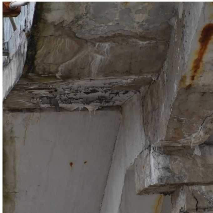
23 pav. Suežijęs betonas.
