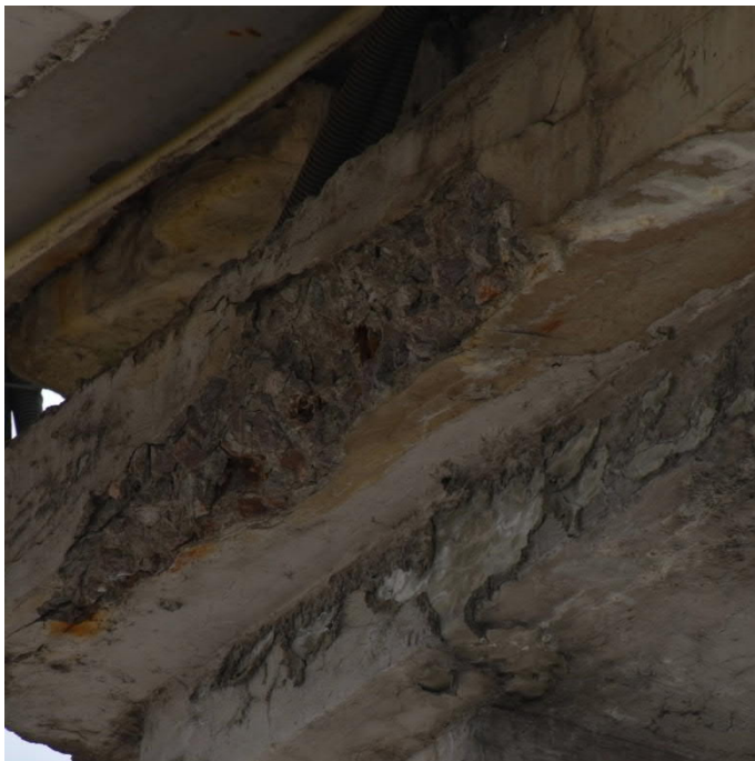
14 pav. Nutrupėjęs betonas nuo atrėminės plokštės kraštų
