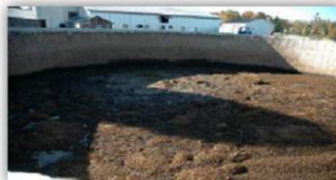
Gülesilo des Betriebs
